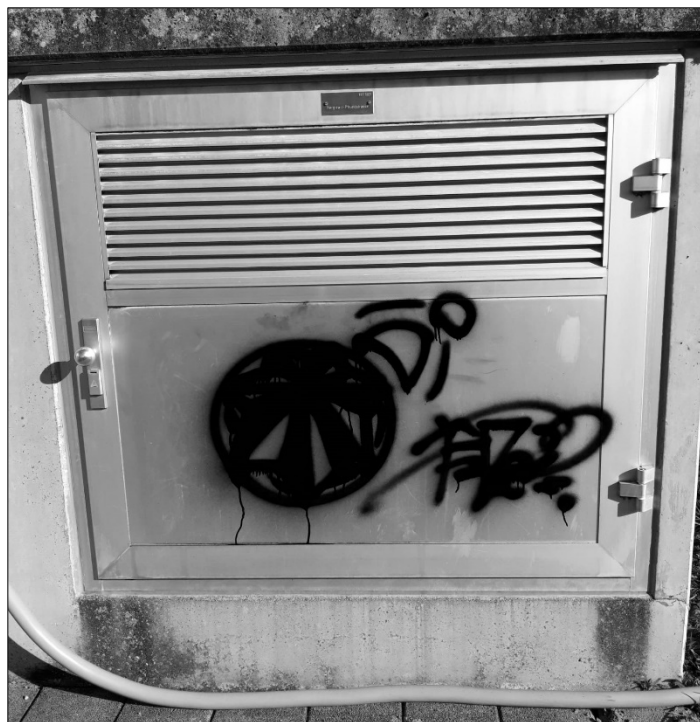
Sprayereien an der Trafostation Pfrundstrasse
